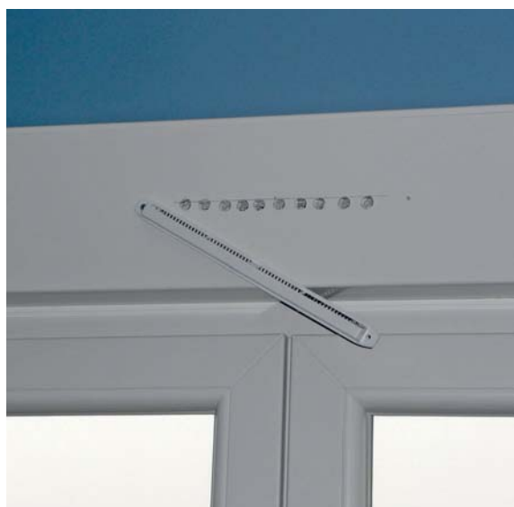
Figure 17 : Réserve mortaise insuffisante - perçage sur chantier (source : Cerema).
