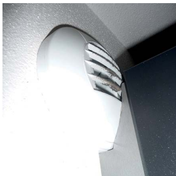
Figure 18 : Obstruction de la bouche d'extraction (source : Cerema).
